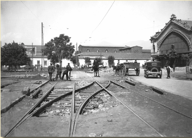
Trabajos de adecuación de las líneas del tranvía frente a la estación Pirque (Bustamante con Providencia), en el contexto de remodelación de Plaza Italia, 7 de diciembre de 1927. Fuente: Grupo Enersis. 2001. Luces de modernidad. Archivo Fotográfico de Chilectra. Santiago: Larreap, p. 38.
