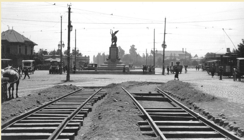
Vista de la Plaza Italia hacia el oriente desde la Alameda. Se observan las vías del tranvía aún en construcción. 7 de enero de 1926. Fuente: Grupo Enersis. 2001. Luces de modernidad. Archivo Fotográfico de Chilectra. Santiago: Larreap, p. 66.
